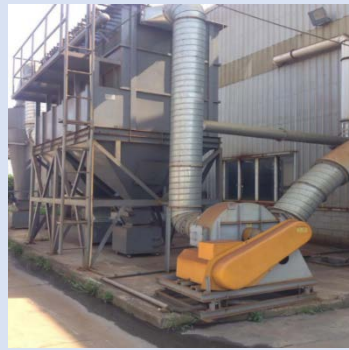
改造後的除塵設備
