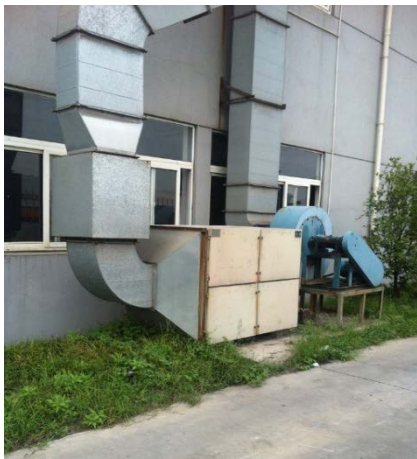
除 VOCs 環保設備
