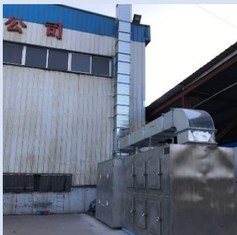
山西圖博新增 VOCs 處理設備，廢氣處理率達 95% 以上
